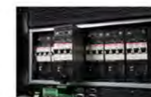
Дополнительный модуль распределения электропитания (RPDC) стоечного монтажа с модулями управления и модулями коммутационных аппаратов, поддерживающими горячую замену
